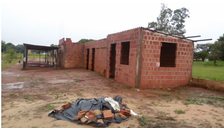
[Figura 24] Quadra 42 – “Praça” – Construção Irregular
